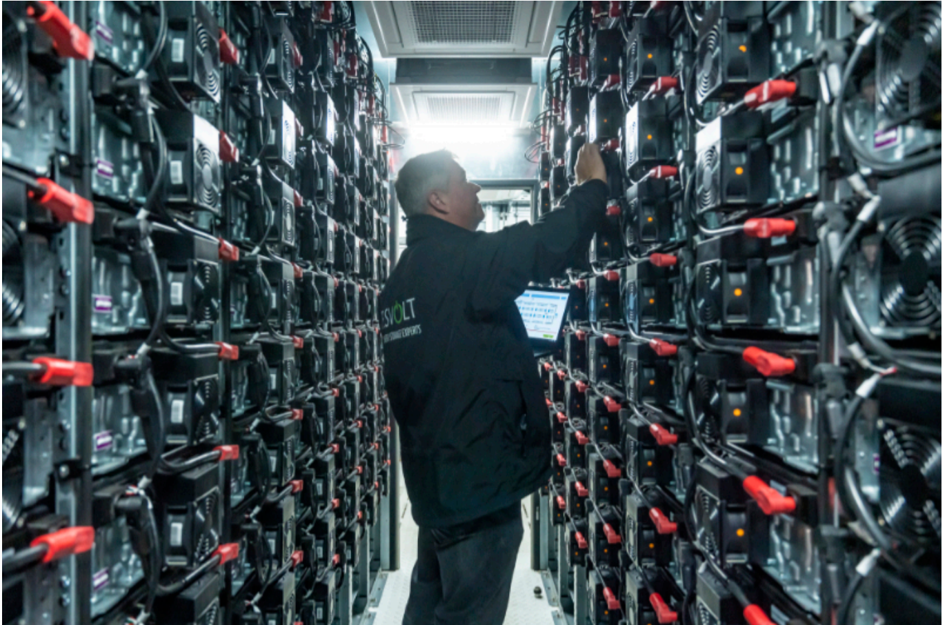
Tesvolt Batteriespeicher. Foto: Tesvolt
