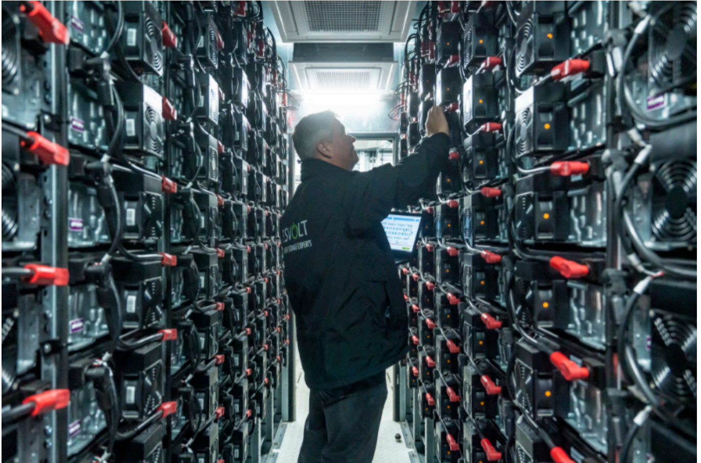
Tesvolt Batteriespeicher. Foto: Tesvolt
