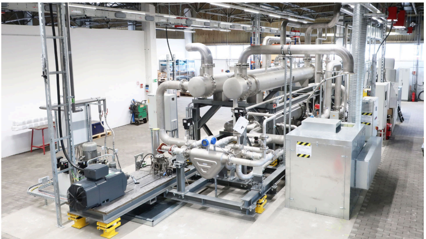
Die Pilotanlage Cobra in der Versuchshalle in Cottbus.
