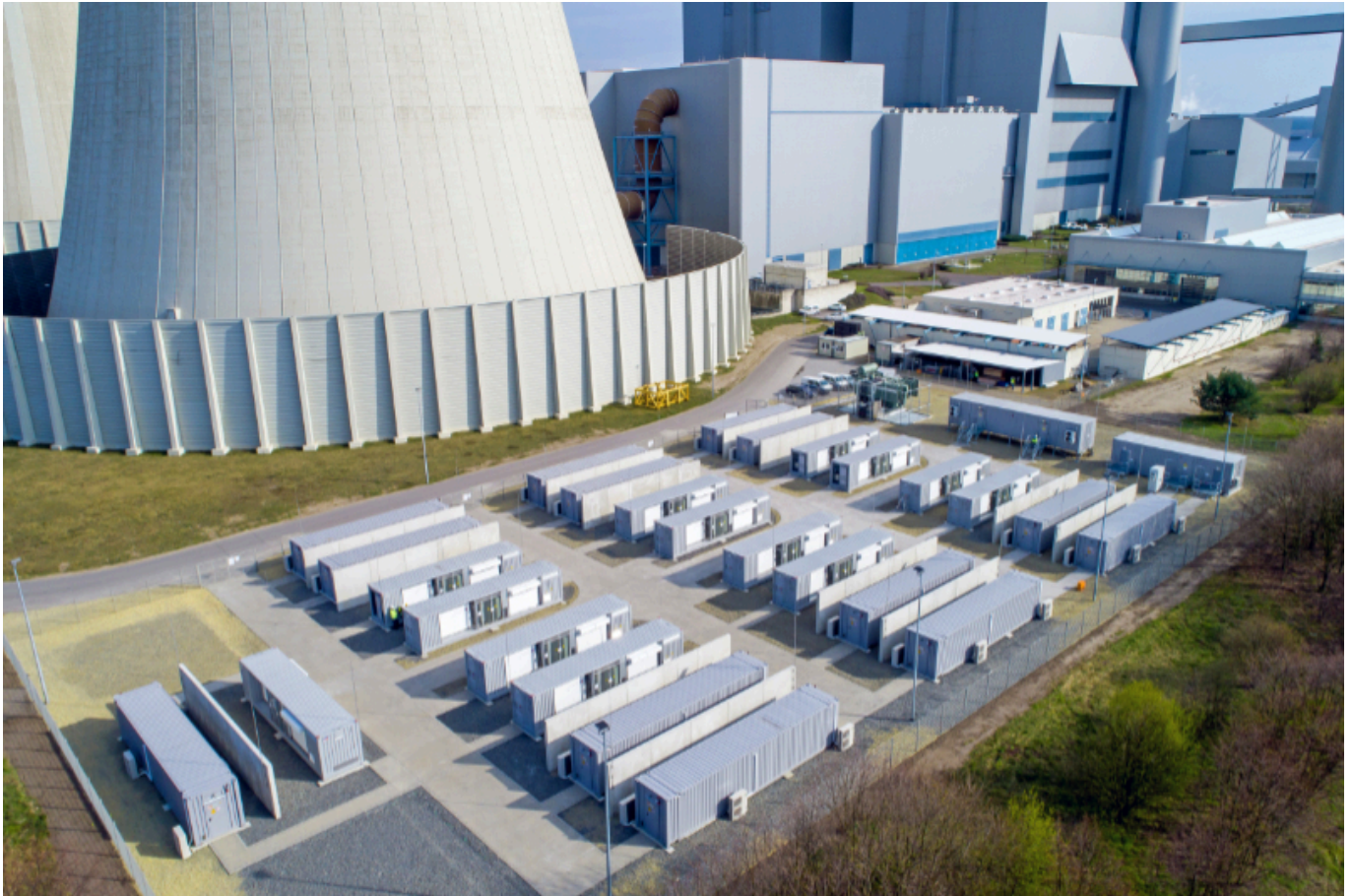
Der größte Batteriespeicher Europas steht in der Lausitz. Copyright: LEAG/ Andreas Franke
