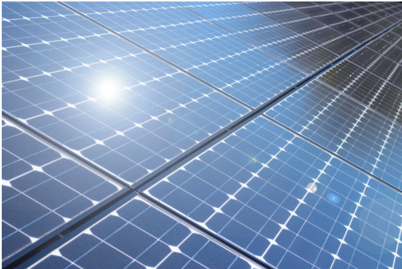
Solaranlage Foto: AdobeStock
