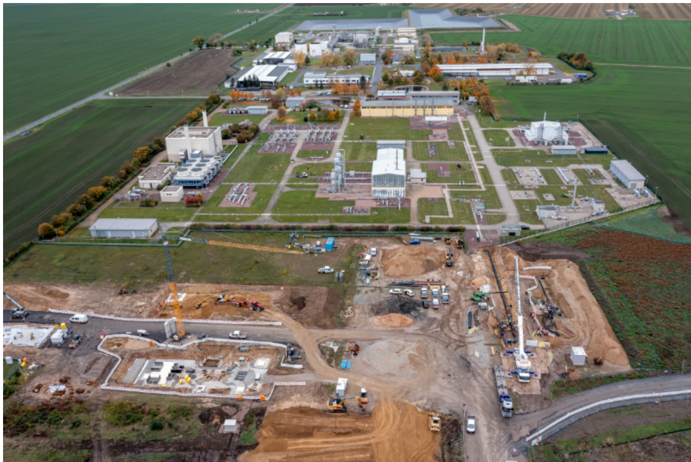
Das Gelände des Energieparks Bad Lauchstädt. Foto: Tom Schulze
