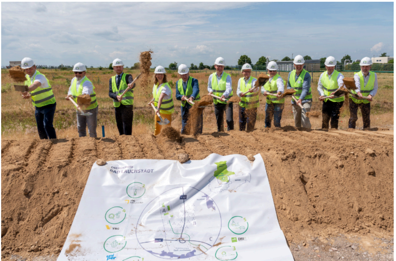
Zum offiziellen Spatenstich für den Energiepark Bad Lauchstädt waren auch die Ministerpräsidenten Michael Kretschmer (3.v.l.) und Reiner Haseloff (5.v.l.) angereist.. Quelle VNG Foto Tom Schulze
